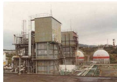
旧三井コークス工業（株）ICI ガス製造設備
